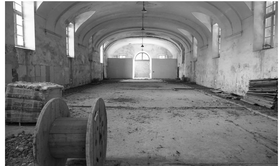
sopra: interno del piano terreno dove le stanze sono incompiute e inutilizzabili; sotto, stato di conservazione degli edifici / / above, interior of the ground floor where the rooms are unfinished and unusable; below, the state of conservation of the buildings
